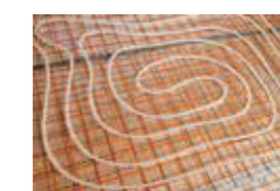
Slučka podlahového vykurovania
